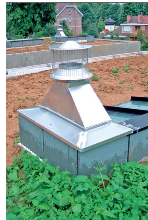
Illustration 56 : Tour d'extraction de ventilation naturelle - Lycée de Caudry, Calais (59) Architectes : QUATR'A Architectes associés (X. Bouffard, J.L. Leclercq).
